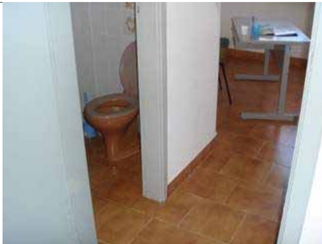
Foto 07: único sanitário existente no prédio, usado tanto pelos pacientes e quanto pelos funcionários.
