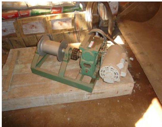
Foto 02: Equipamento integrante da câmara fria (motor)
