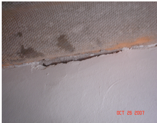
CLÓVIS LEWANDOVSKI: Reboco com frestas.
