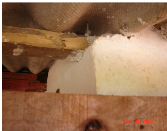
Rachadura num dos caibros.
