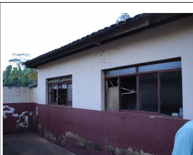
Foto 2: Vista externa da Creche Vó Neném no Distrito de Santa Filomena em péssimo estado de conservação.
