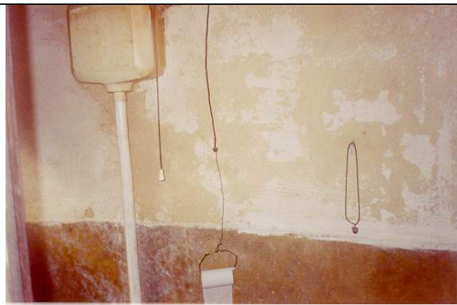
Foto 2- Caixa de descarga com vazamentos e acabamento das paredes mal executado.
