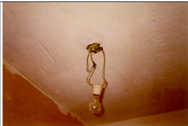
Foto 1- Instalação elétrica precária, fato comum em todos os sanitários vistoriados.
