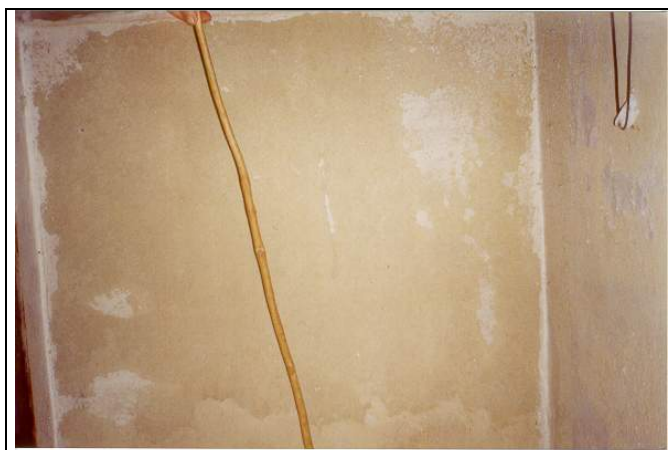
Foto-3- Parede com reboco esfarelado ao simples toque, convalidando a má qualidade das obras.
