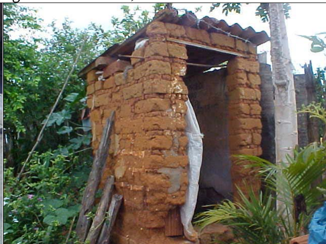
Foto 2 - Sanitário rústico, pre-existente em moradia da Beneficiária 02 - Estrela
