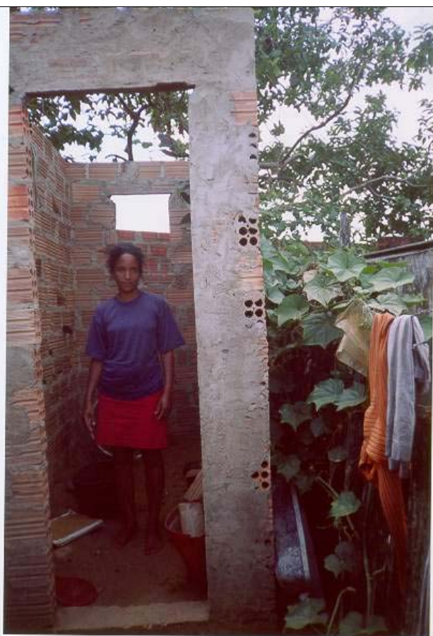
Foto 3 - Beneficiário 24 da Relação. R. Caetés, 13 – Bairro Saudade; banheiro inacabado.
