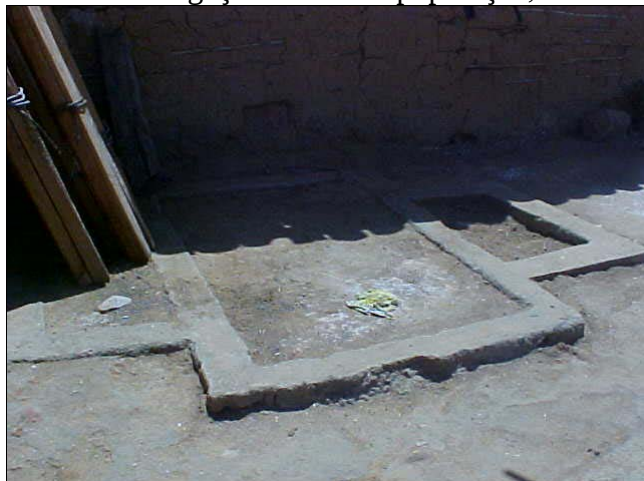
Foto 1 – Nessa residência apenas o alicerce do módulo sanitário foi construído – Beneficiária 02 - Estrela
