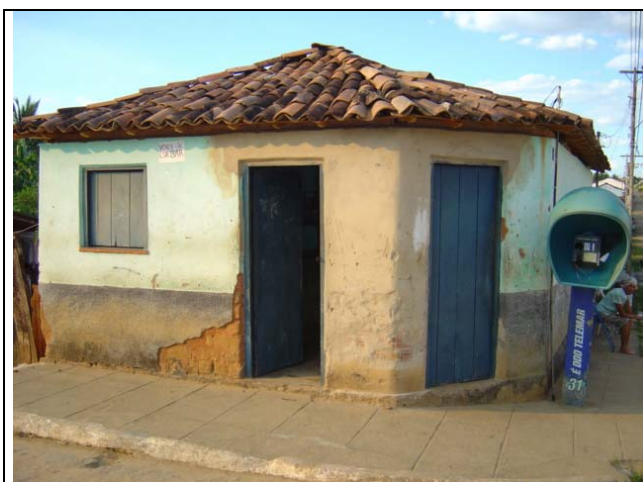
Foto (01) – Vista externa da sala de aula, custeada pelo próprio Alfabetizador, com pagamento de aluguel no valor de R$ 30,00 mensais, evidenciando a falta de atuação/articulação entre as partes envolvidas no Programa.
