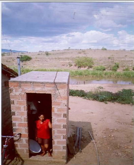
Foto 1- Beneficiário 09 da Relação. R. Novo Horizonte, s/n, Bairro Saudade; banheiro inacabado.
