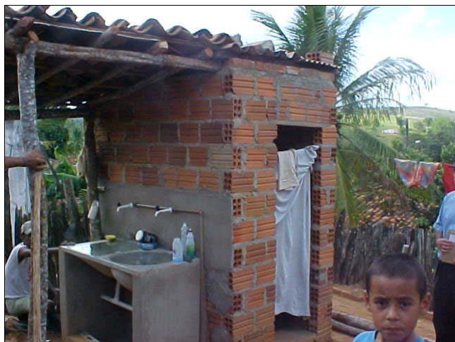
Foto 3 – Residência onde deveria ter sido construído o módulo sanitário completo. A pia foi adquirida pelo próprio morador. Beneficiário 5 – Estrela
