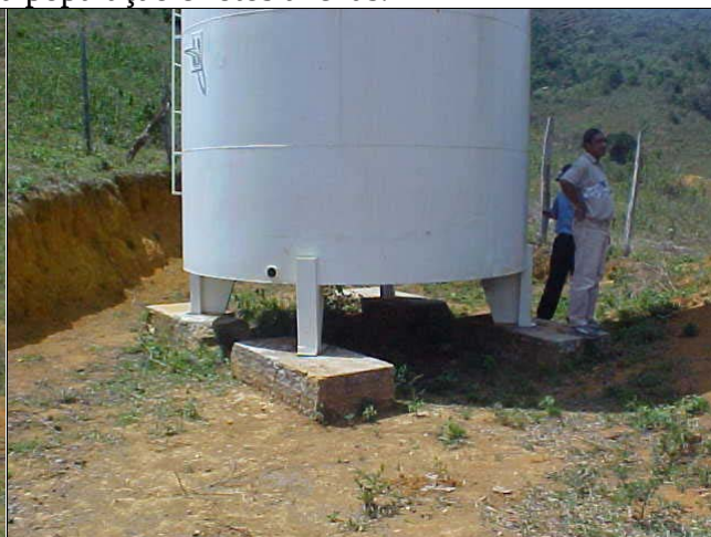
Foto 2 - Reservatório metálico, sem alimentação de água
