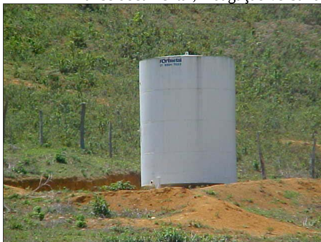
Foto 1 – Reservatório metálico, sem alimentação de água
