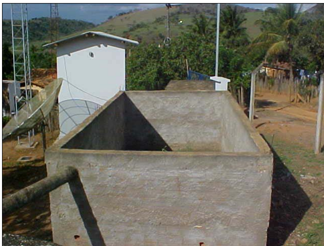
Foto 3 - Reservatório em total abandono, sem cobertura.
