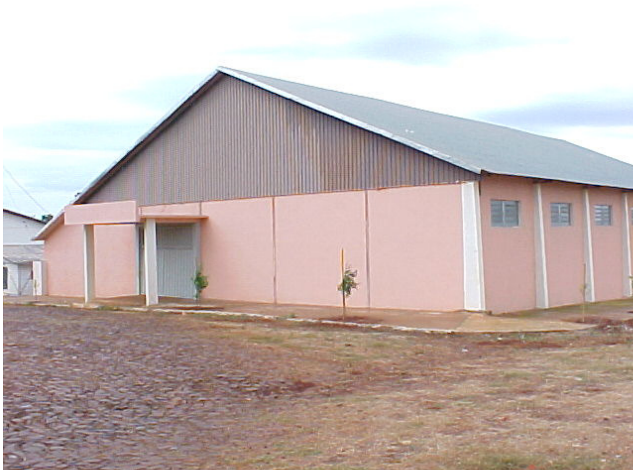
Foto 3: Vista externa com destaque para o avanço sobre o passeio público.
